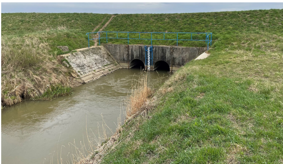
18. ábra: A Keszeg-ér bújatója a Répce-árapasztó keresztvezésénél (47+950 km)
